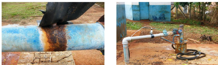
Figura 11 – Estado de Conservação Poço
