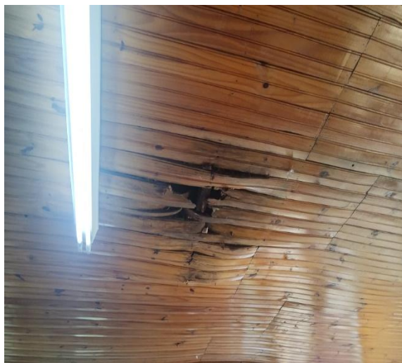
Forro danificado em uma das salas de atividades, apresentando risco de queda
