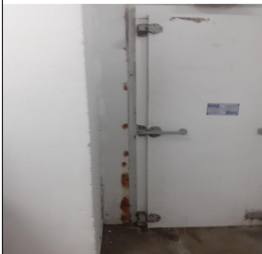
Porta da câmara fria com sinais de deterioração (ferrugem)
