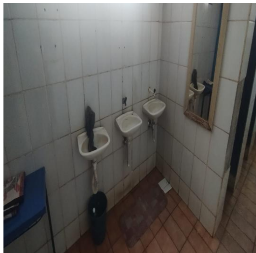
Banheiros em situação precária, com torneiras e vasos sanitários fora de funcionamento
