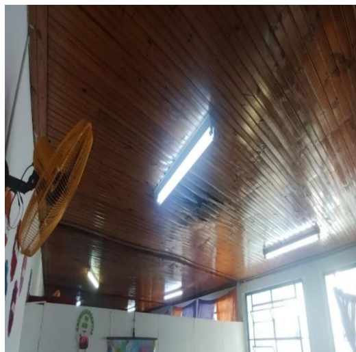
Ausência de cortinas nas salas, sendo utilizada improvisação com tecido TNT
