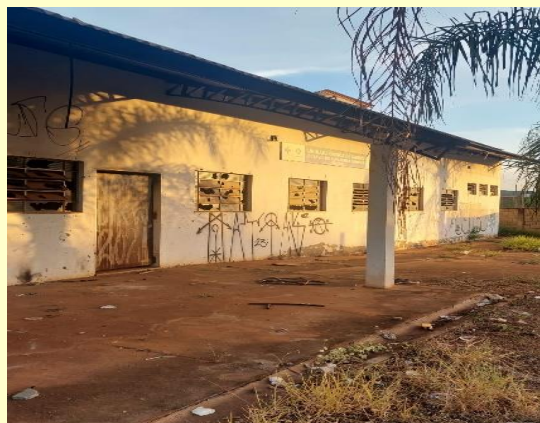
Situação verificada no 1º acompanhamento/2023
